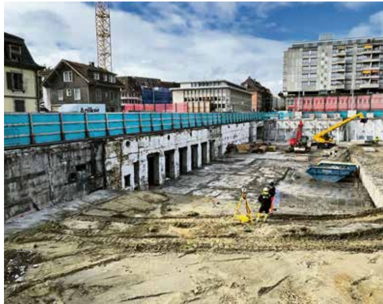
Meinen Nord (Blick gegen Westen): Die Baugrube ist bereit für die ersten Hochbauarbeiten. (M. Egger)
