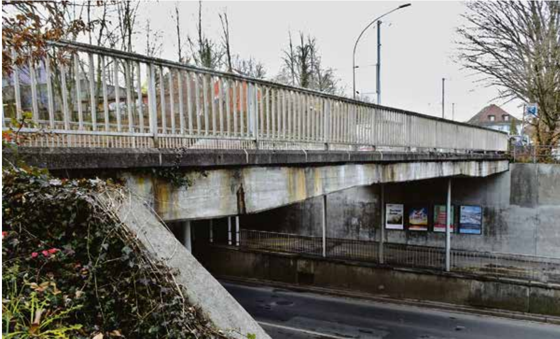
Die Brücke über die Schwarzenburgstrasse wird seit dem 2. April saniert (Foto: ingenta.ch)
